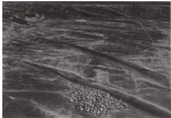
Abb. 6: Bei ihrer Überschüttung mit Flächenfilterkies verweilte Kunststoff-Dichtungsbahnen nach ihrer Wiederaufgrabung
